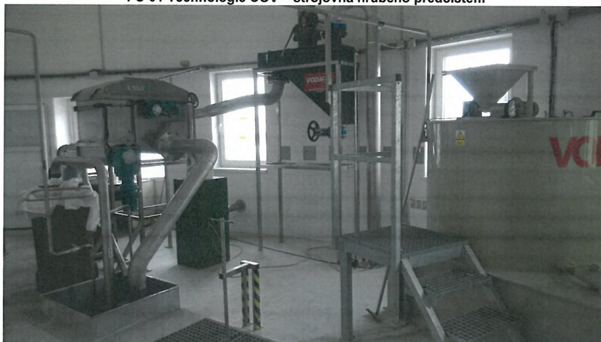
PS-01 Technologie ČOV – strojovna hrubého předčištění
